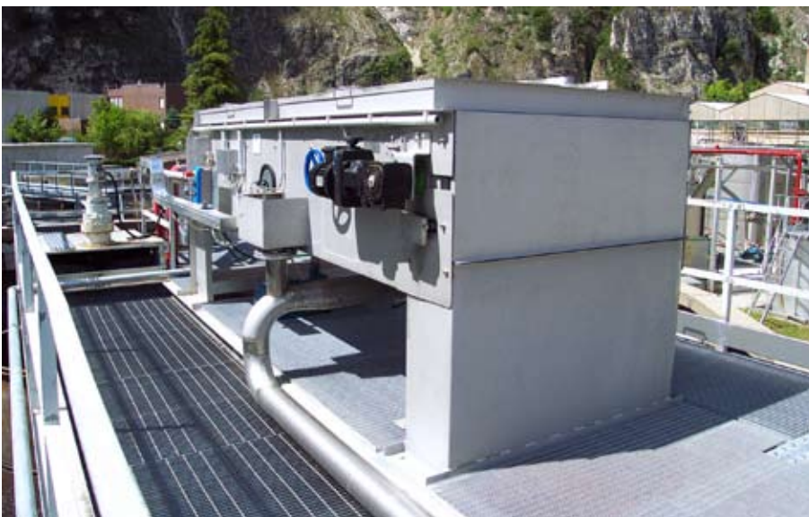
Einsatzbeispiel 5: Außenaufstellung eines BGT 1000 in gekapselter Ausführung in Norditalien.
