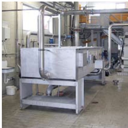
Einsatzbeispiel 3: Ergänzung einer Schlammeyndickungsanlage mit einem Bandeindicker BGT 1000 auf einer norddeutschen Kläranlage.
