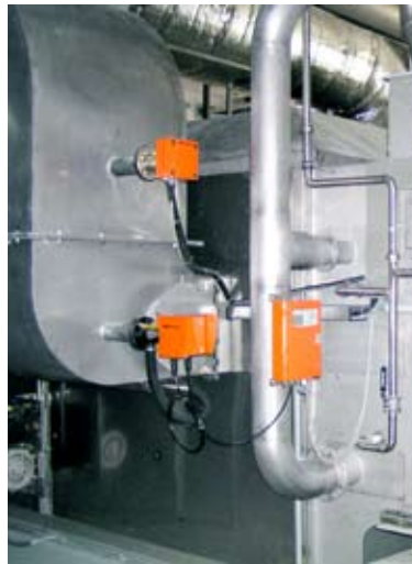
Erfüllung der ATEX-Vorschriften durch umfangreiche Sicherheits- und Messtechnik (Österreich)
