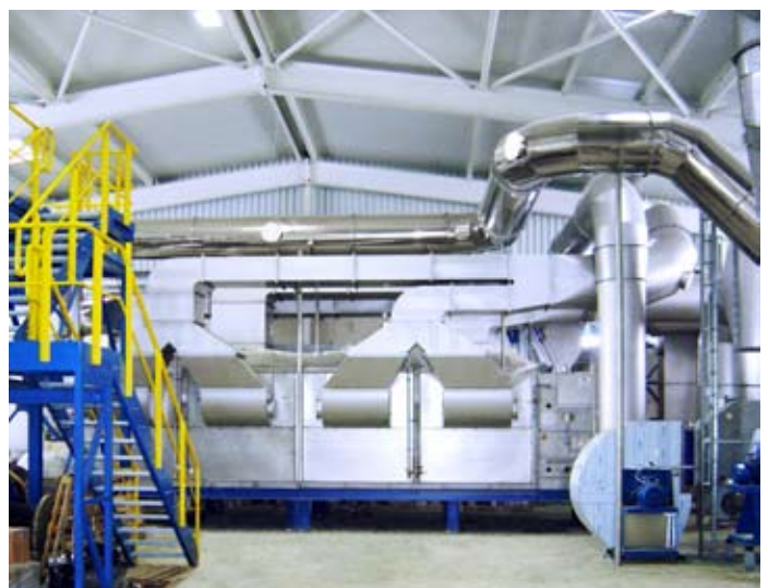
Nutzung von Abwärme aus einer Bioabfallvergärungsanlage (Deutschland)
