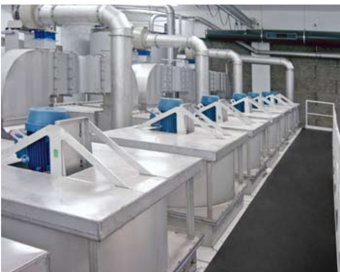
Detaillansicht auf die Ventilatoren des Klärschlammrockners in Oyonnax (Frankreich)
