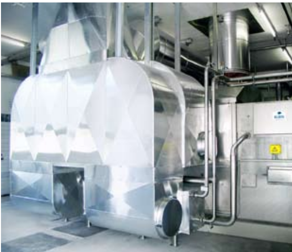
Detaillierte Ansicht der isolierten Luftkanäle aus Edelstahl (Österreich)
