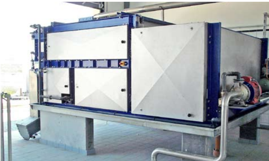
Eingehauste Siebbandpresse SNP 2500 für die Entwässerung von Faulschlamm (Deutschland)
