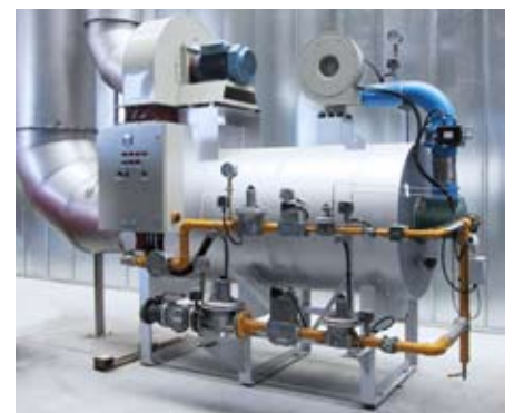
Kombinationsbrenner für Bio- und Erdgas als Wärmequelle für die Trocknung,
