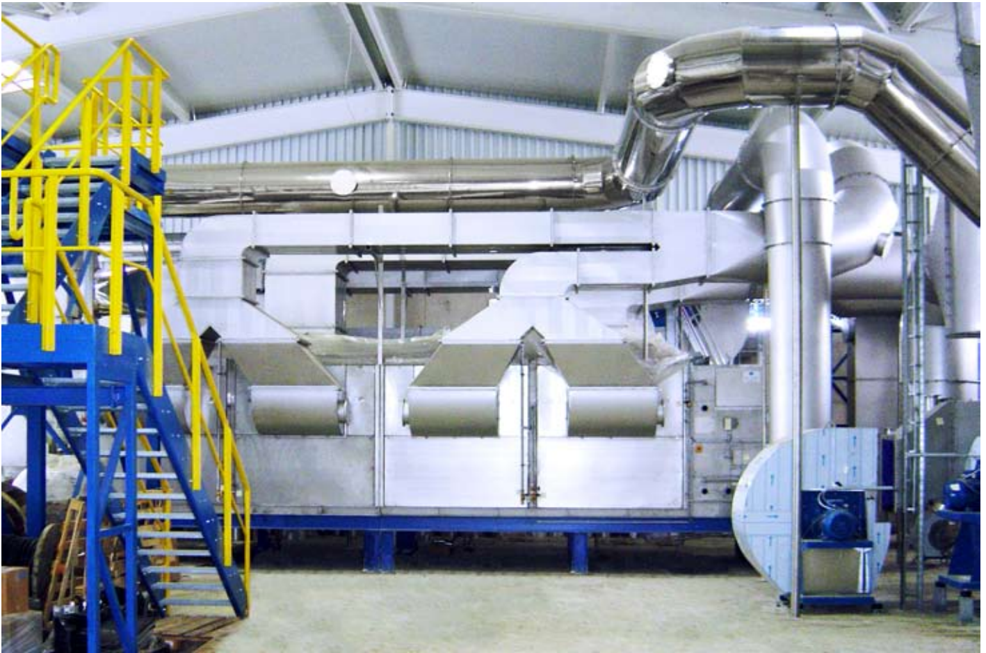
Nutzung von Abwärme aus einer Bioabfallvergärungsanlage
