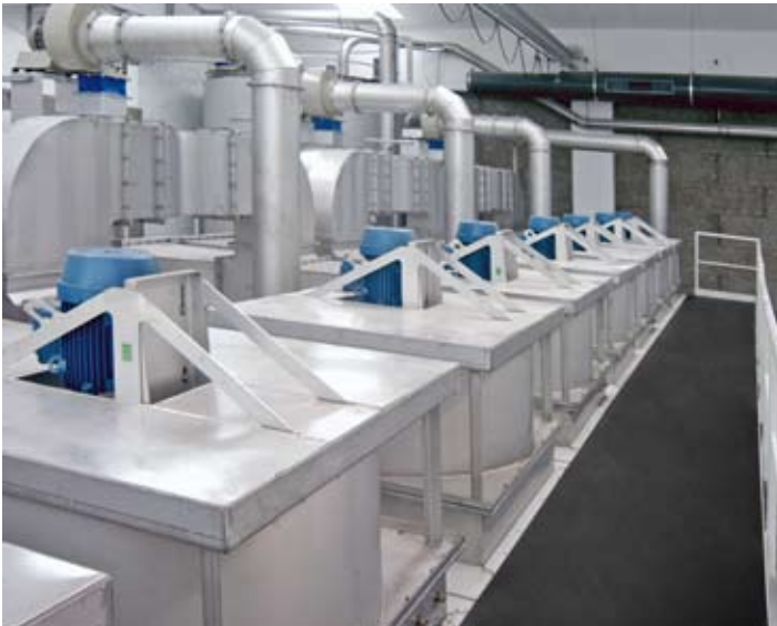
Bandrockner Pro-Dry® in einer Kläranlage in Frankreich
