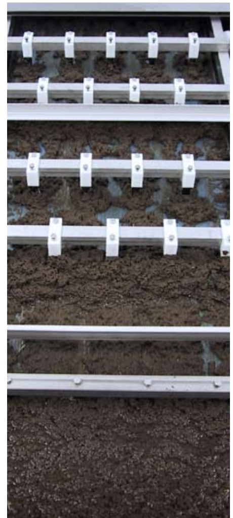
Blick auf einen Bandeindicker, die Volumenreduktion des Überschussschlammes während des Eindickungsprozesses ist deutlich erkennbar
