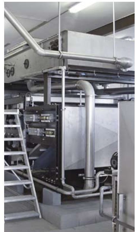
Schlammwässerung mit einer Kombinationsmaschine aus Siebbandpresse und aufgesetztem Bandedicker
