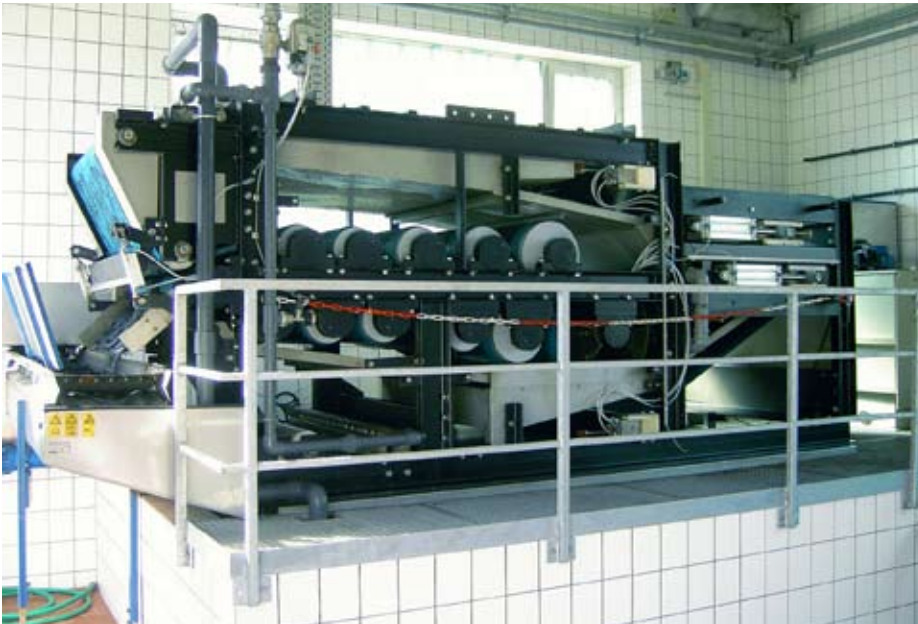
Schlammwässerung mit einer Siebbandpresse SNP 1200, in ein bestehendes Gebäude integriert (Deutschland)
