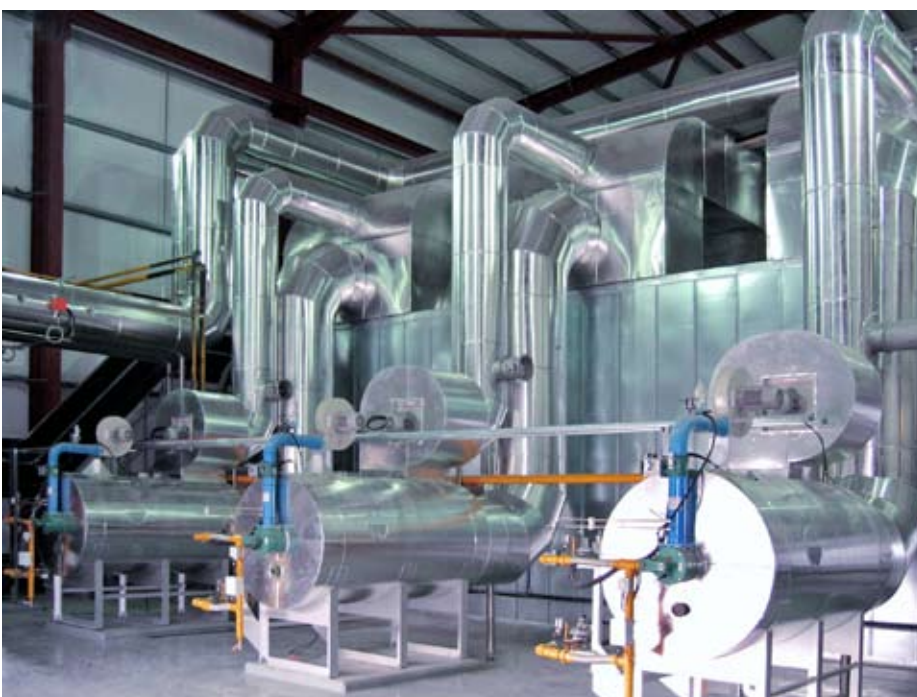
Bandrockner, Nutzung von Warmwasser aus einem Blockheizkraftwerk
