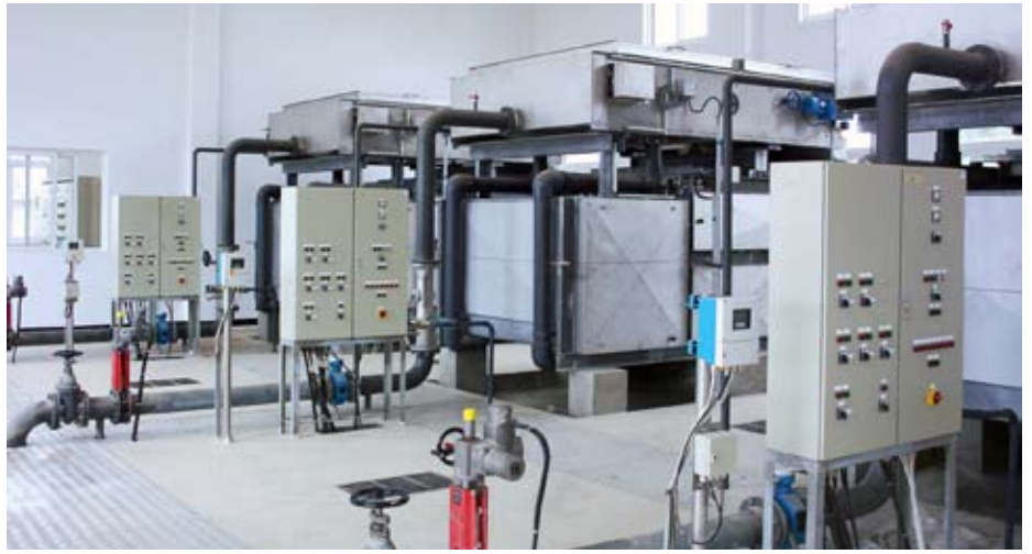
Anlage mit 3 Siebbandpressen vom Typ SNP 1800 zur maschinellen Entwässerung von kommunalem Klärschlamm
