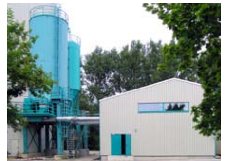
Komplette Trocknungsanlage einer Kläranlage für 200.000 Einwohnergleichwerte, Nutzung von Warmwasser zur Klärschlamm-trocknung
