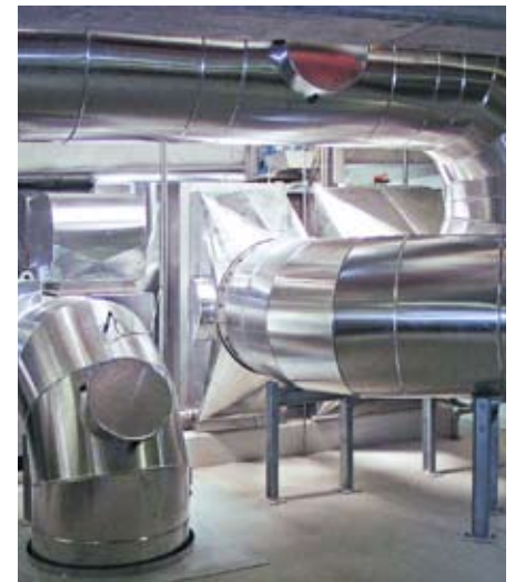
Luftkanäle eines Bandrockners für die Wärmerückgewinnung
