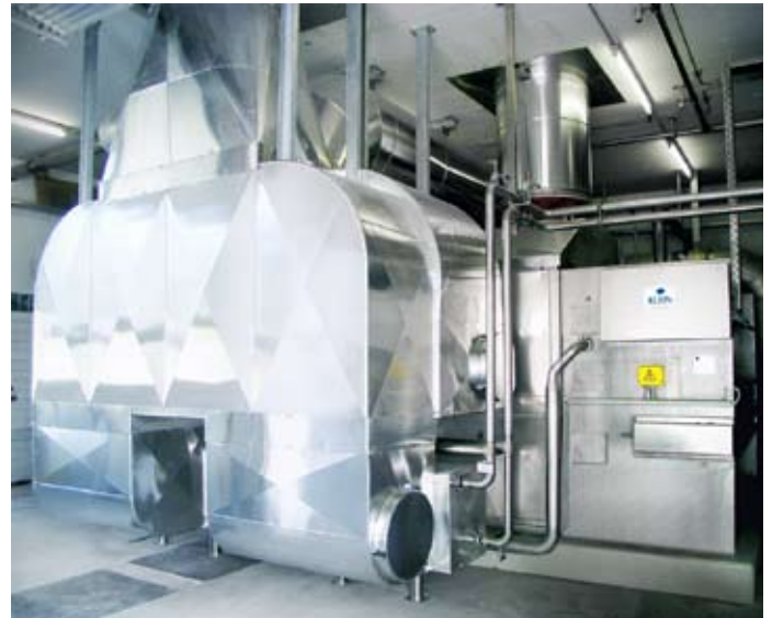
Nutzung von Abwärme aus einem Fettverbrennungsmotor zur Klärschlamm-trocknung, hier: detaillierte Ansicht der isolierten Luftkanäle aus Edelstahl (Österreich)
