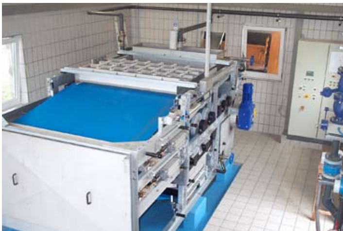
Einsatzbeispiel 5: Installation einer Schlammmentwässerungsanlage im süddeutschen Raum mit tiefer gesetztem Fundament als Filtratwanne.
