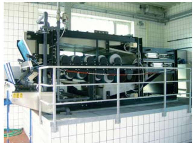
Einsatzbeispiel 6: Schlammmentwässerung mit Siebbandpresse SNP 1200, integriert in ein bestehendes Gebäude.
