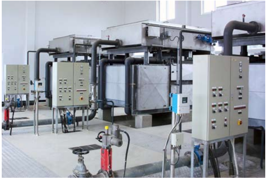
Einsatzbeispiel 1: Anlage mit 3 Siebbandpressen vom Typ SNP 1800 zur maschinellen Entwässerung von kommunalem Klärschlamm
